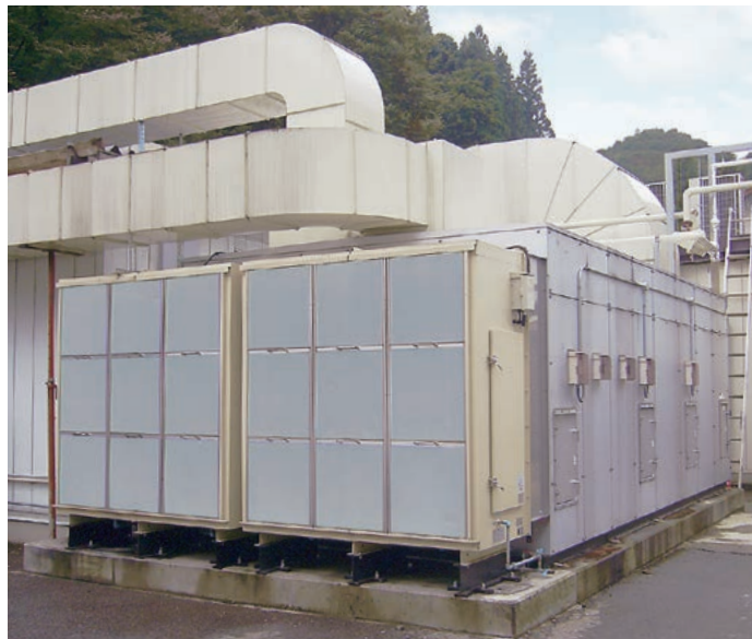
クールユニット(CU) 地上設置 ▶
