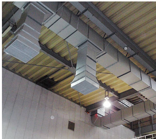
▲ クールクリーンファン(CC) 室内ダクト・吹出口
