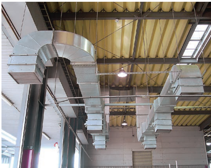
▲ クールクリーンファン(CC) 室内ダクト・吹出口
