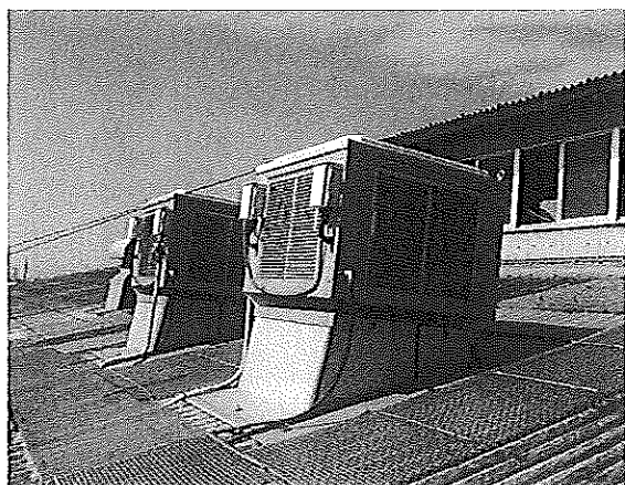
写真1 屋根上への設置例
